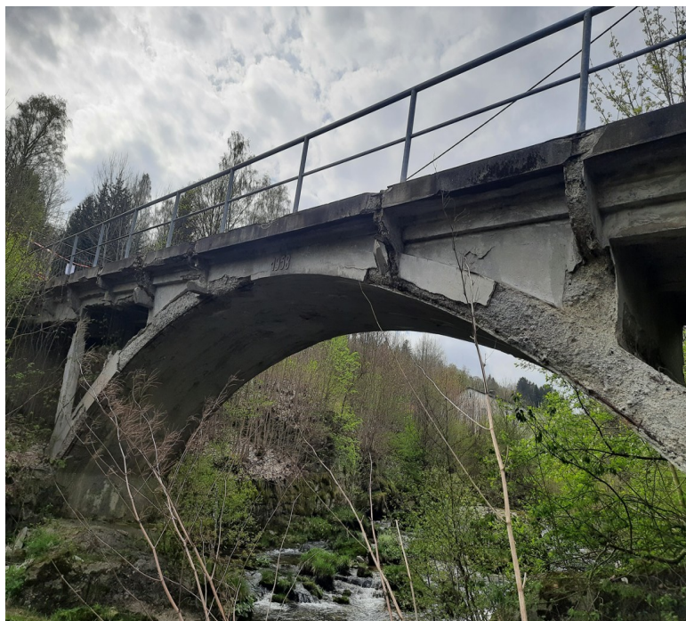
Pohled nosné konstrukce hlavního pole s degradující vrchní vrstvou betonu a obnaženou výztuží
